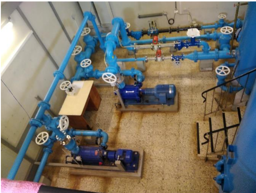
Abbildung 140: Pumpen Druckerhöhung Mausgesees
