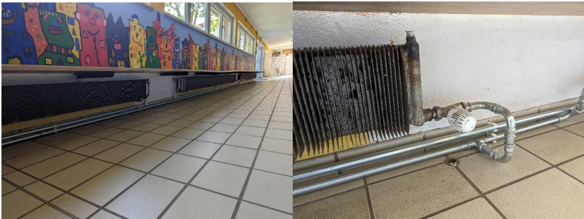
Abbildung 49: Heizung Flur Grundschule
