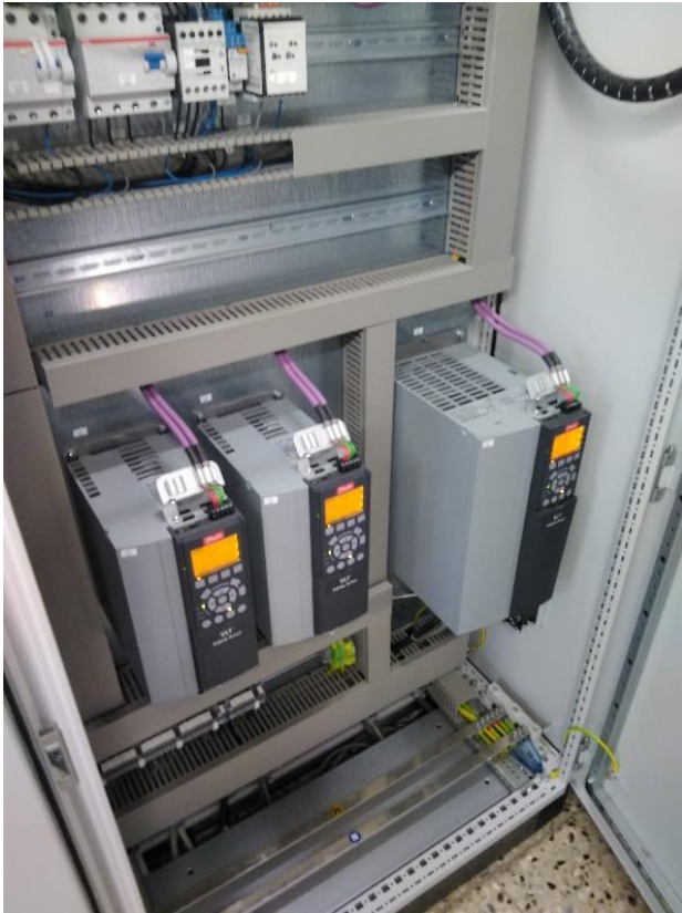
Abbildung 141: Pumpen Druckerhöhung Mausgesees
