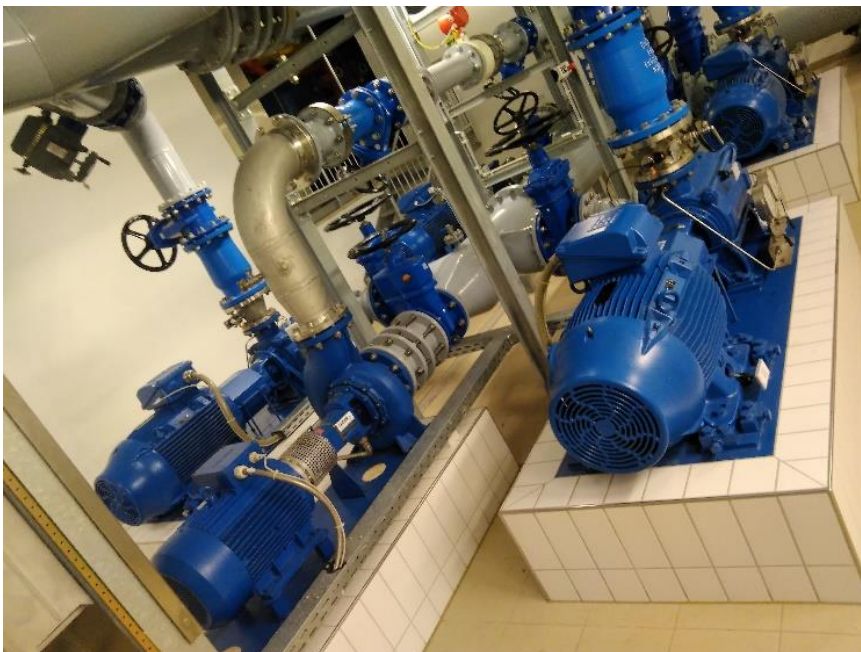
Abbildung 119: Pumpen in der Aufbereitungsanlage
