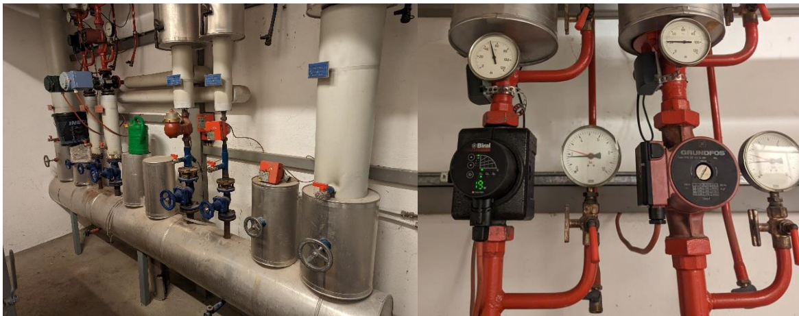
Abbildung 59: Wärmeverteilung / Heizungspumpen Grundschule
