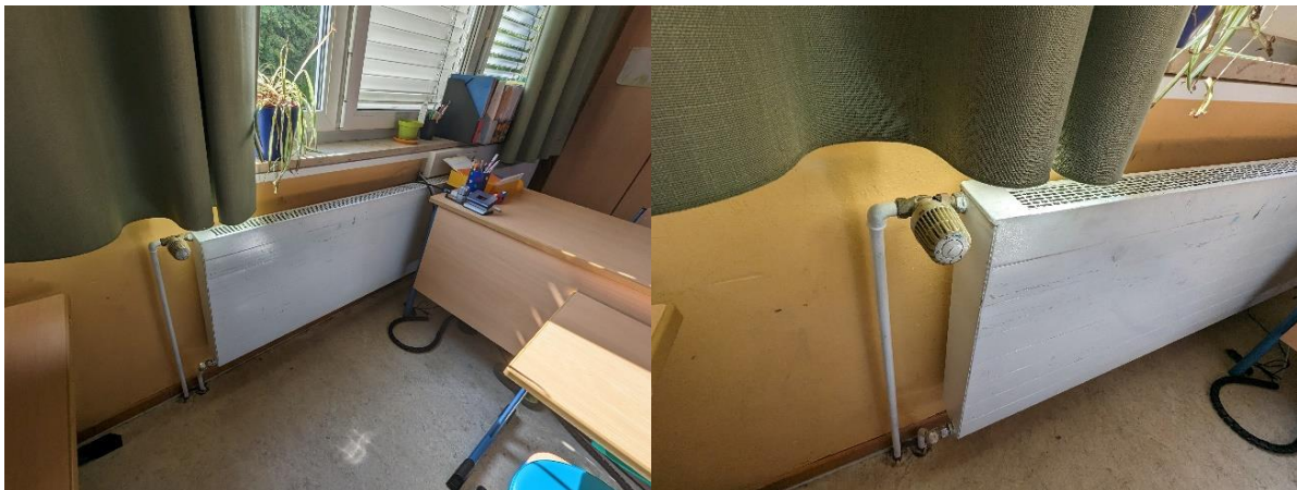
Abbildung 51: Heizkörper Zimmer Aulabereich
