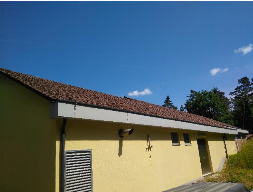
Die Dächer der Aufbereitung sind ca. 30 – 40 Jahre alt und mit Betonziegeln eingedeckt.
