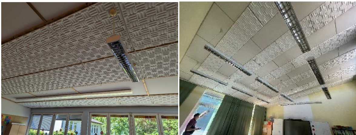
Abbildung 56: Klassenzimmer mit Leuchtstoffröhren
