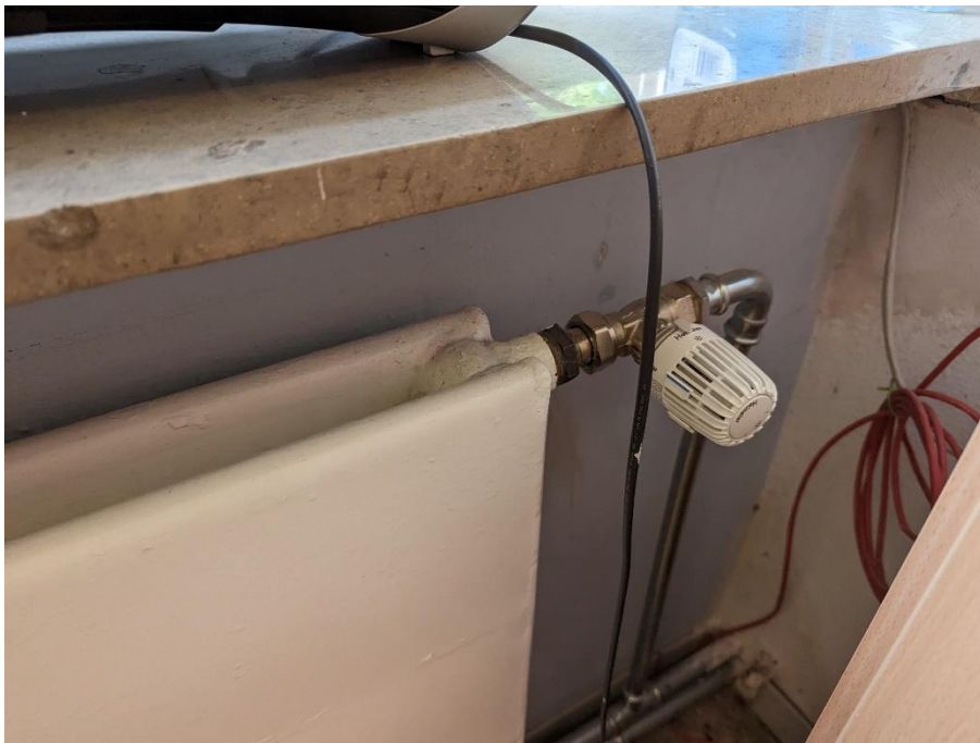
Abbildung 47: Heizkörper Klassenräume Grundschule
